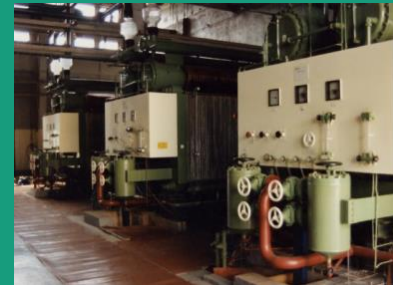
Elektrolyseure mit insgesamt ~ 33 GW el (Verkehr, Transport)
