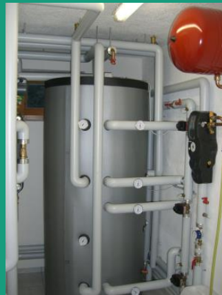
Wärmespeicher in Gebäuden ~ 320 GWh (d.h. 7 Mio Einheiten á 800 Liter)
