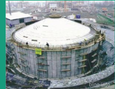
Großwärmespeicher in Wärmenetzen ~ 350 GWh (d.h. 150 Einheiten á 50.000 m 3 )
