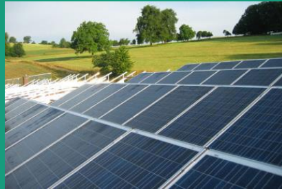
Photovoltaik ~ 147 GW el
