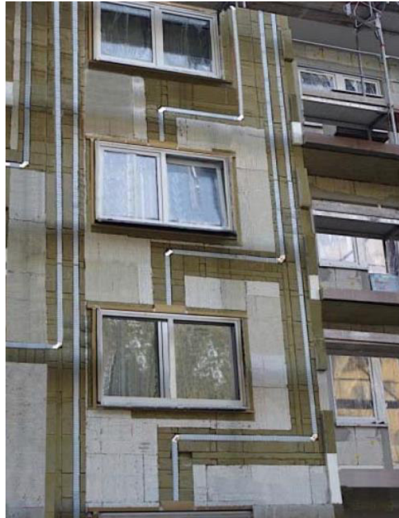
Abbildung 10 – Fassadennintegrierte Leitungen in Mineralwolle, vor Einbau der Mineralwolle-Deckplatte, Projekt RetroKit (RetroKit Project 2016).
