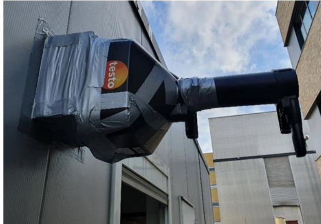
Abbildung 25 – Messung des Volumenstroms eines Pendellüfters am ESHL
