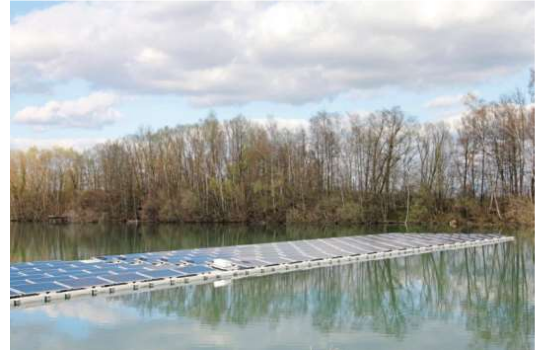
Schwimmende 750 kW PV-Anlage in Renchen auf dem Baggersee Maiwald (Erdgas Südwest, 2019)
