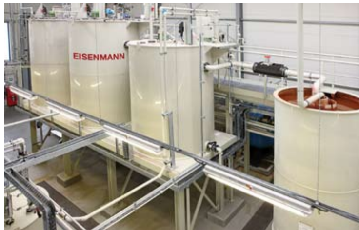
Oxidative Abwasserreinigung in der Pflanzenschutzmittelproduktion mit dem Fentox-Prozess (Bild EISENMANN)
