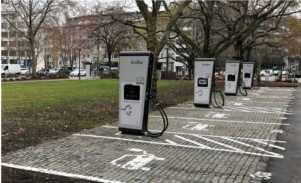
Abbildung 1-1: Urbaner DC-Ladepark in der Rotebühlstraße in Stuttgart. Aufgebaut im Rahmen des Projekts »USP-BW«. (Foto: Felix Röckle, Fraunhofer IAO)
