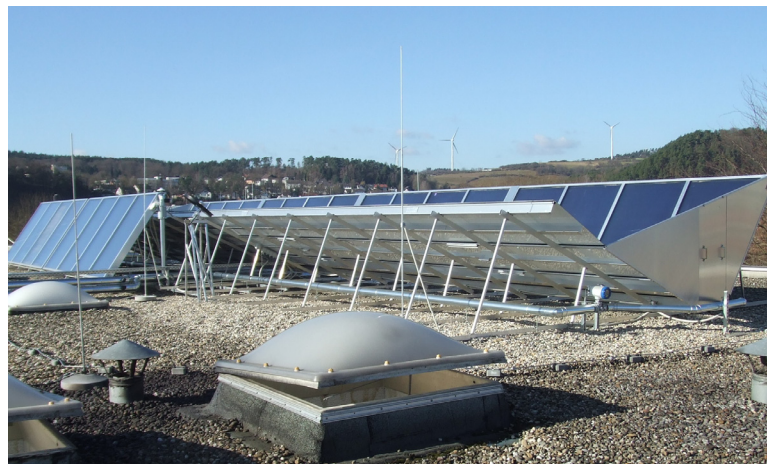
Abb. 1: Kollektorfeld der Pilotanlage auf dem Dach der Wäscherei Laguna in Marburg (Lahn).
