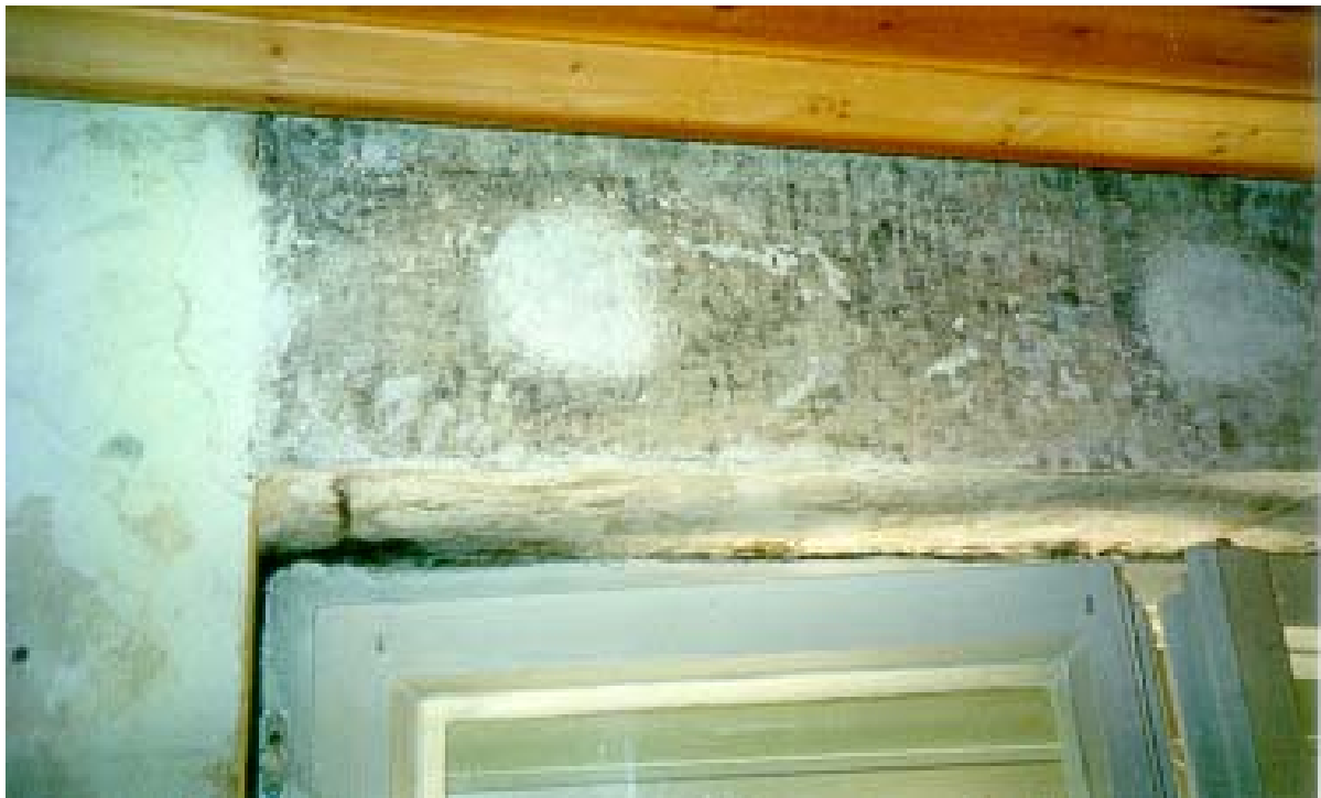
Bild 6 Stockflecken über dem Fenstersturz nach Abnahme einer punktwise verklebten Innendämmung aus gipskartonkaschierten Polystyrol-Hartschaumplatten.
