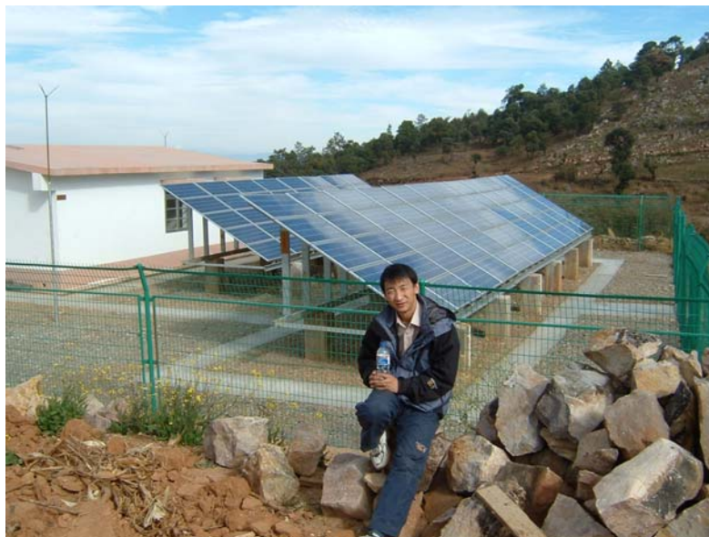
Bild 9: PV-Generator und Technikhaus für AC-gekoppelte Dorfstromversorgung in der Provinz Yunnan
