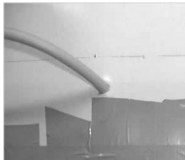
Abb. 10: Nicht abgeklebte Durchdringung eines Elektrokabels durch die Dampfbremse [Hall und Hauser (2003)]
