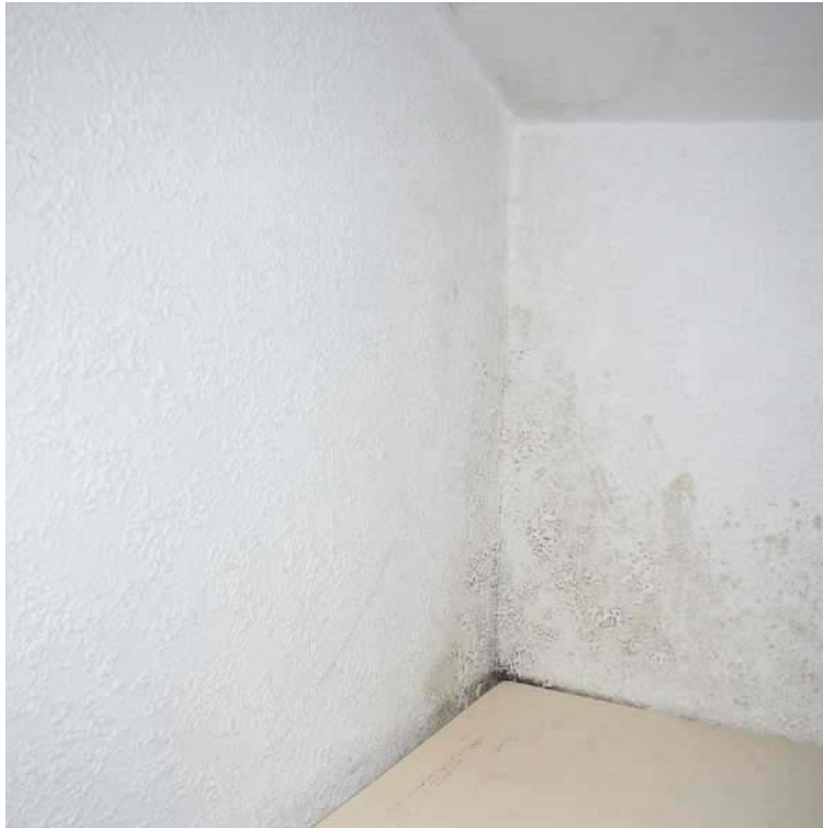
Bild 9: Ansicht der Wand hinter den Büchern mit Schimmelbildung.
