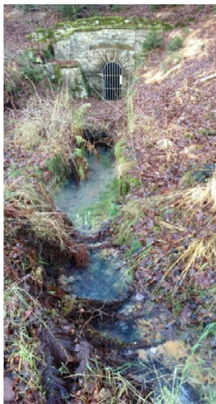
Abbildung 1: Mundloch des Verträgliches Gesellschaftstollens mit Wasseraustritt in den „Roten Graben“
