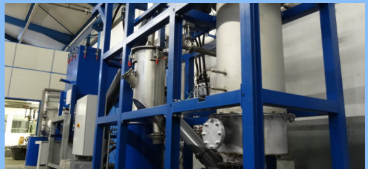
Festbett-Vergasungsanlage zur Erprobung verschiedener Einsatzstoffe
