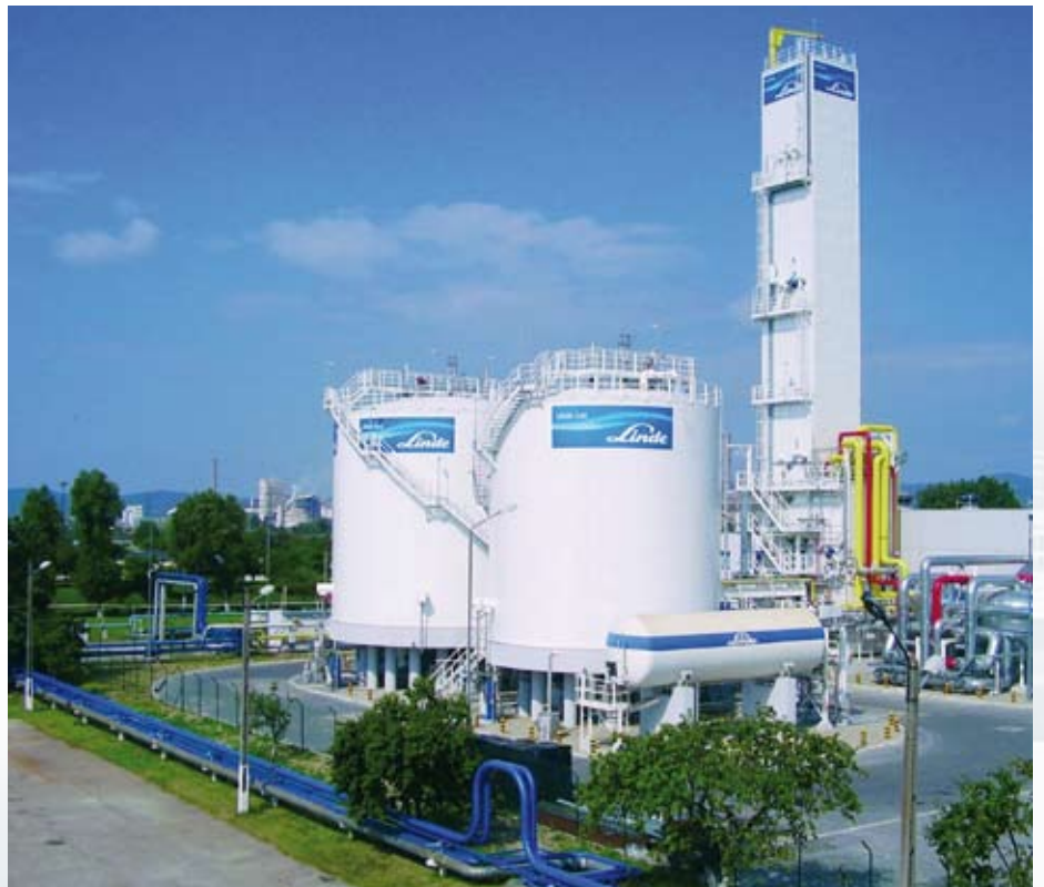
Luftzerlegungsanlage des Industriepartners Linde-KCA; Copyright: Linde-KCA
