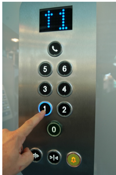
Stockwerk- und Fahrtrichtungsanzeige
