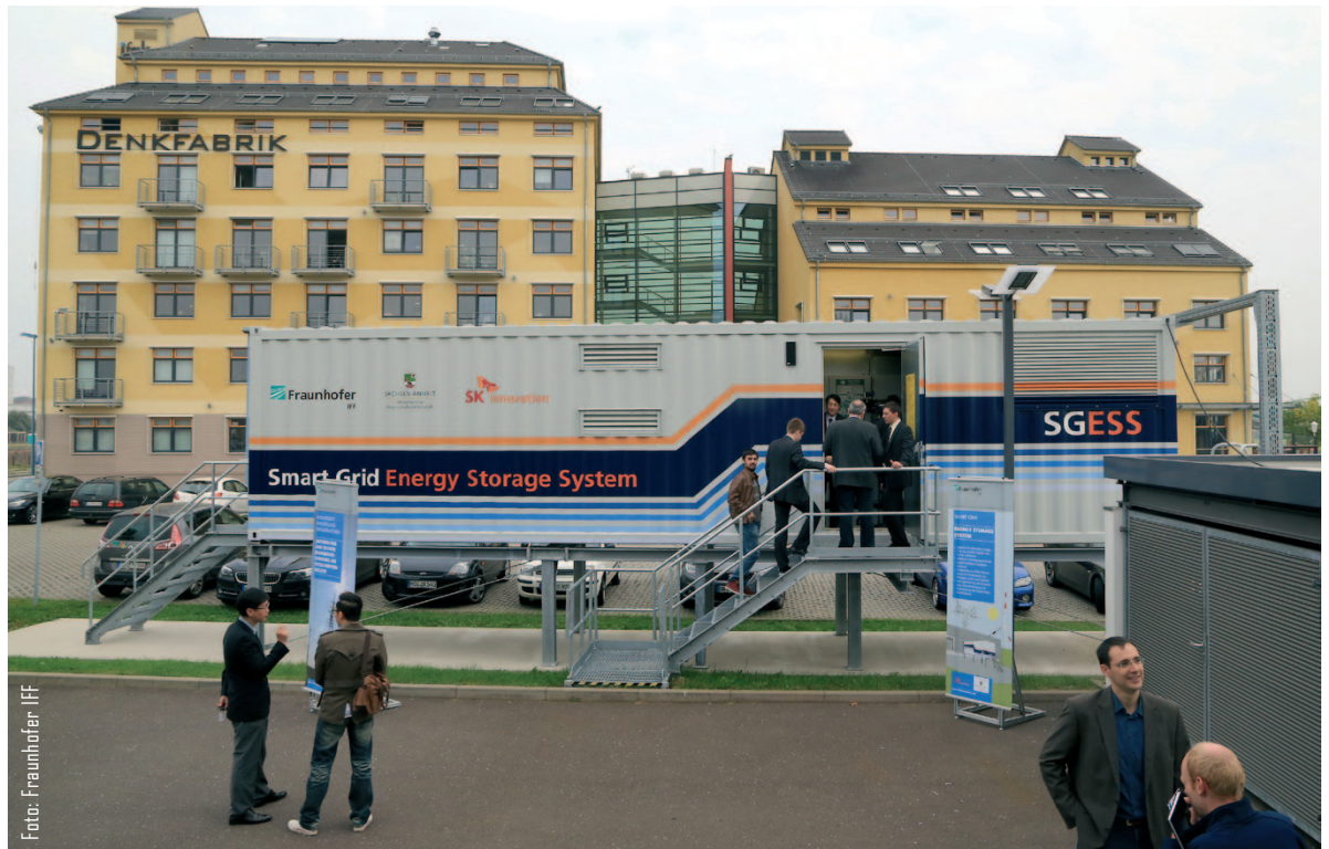
Der Batteriegroßspeicher des Fraunhofer IFF im Magdeburger Wissenschaftshafen.
