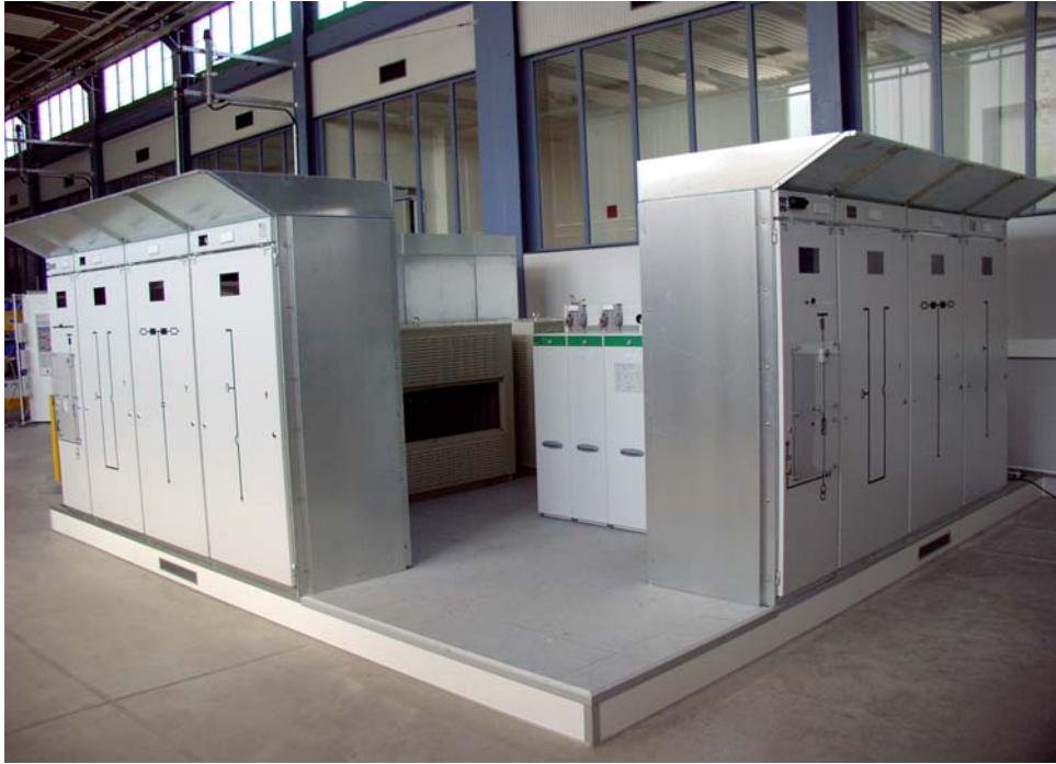
Bild 3: Ausführung der MNN in Mittelspannungs-Schaltschranktechnik
