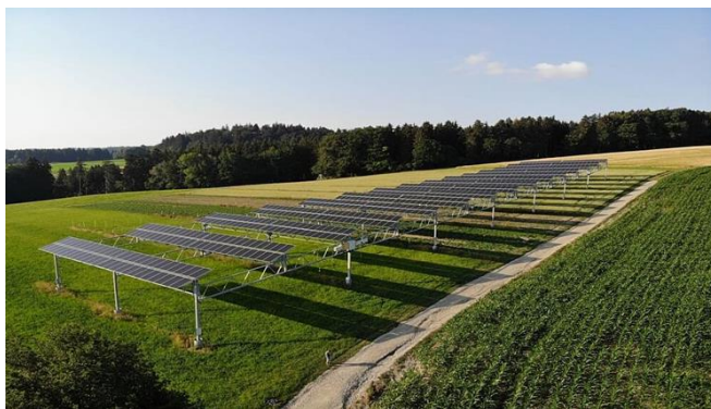
Fig. 27 Agri-PV-Anlage, Hofgemeinschaft Heggelbach, Herdwangen-Schönach (Foto: BayWa r.e.).
