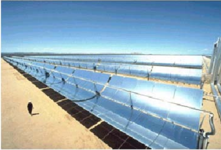
Abbildung 4-43: Parabolrinnen zur solarthermischen Stromerzeugung
