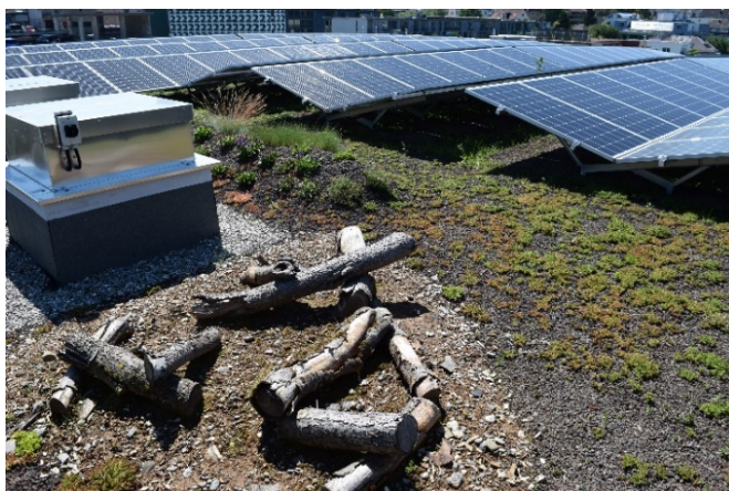
Abbildung 14: "Solar-Biodiversitätsgründach": Arten- und struktureiches Solargründach (Quelle: BuGG)
