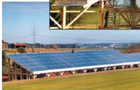
Bild 13 Kran-Montage eines SOLARroof FDKKollektorelements auf einer Sporteinrichtung (Sommerstockbahnhalle Attenkirchen). Der Kollektor speist die Solarwärme in ein Nahwärmenetz mit Saisonspeicher.
