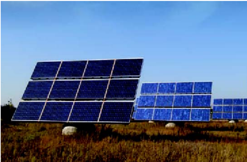
Abbildung 1: Der Solon Mover: Eine nachgeführte Freiflächenphotovoltaikanlage (Quelle: Solon AG 2006)
