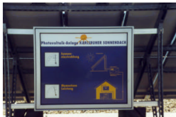
Bild 5: Leistungsanzeige des »Karlsruher Sonnendachs«
