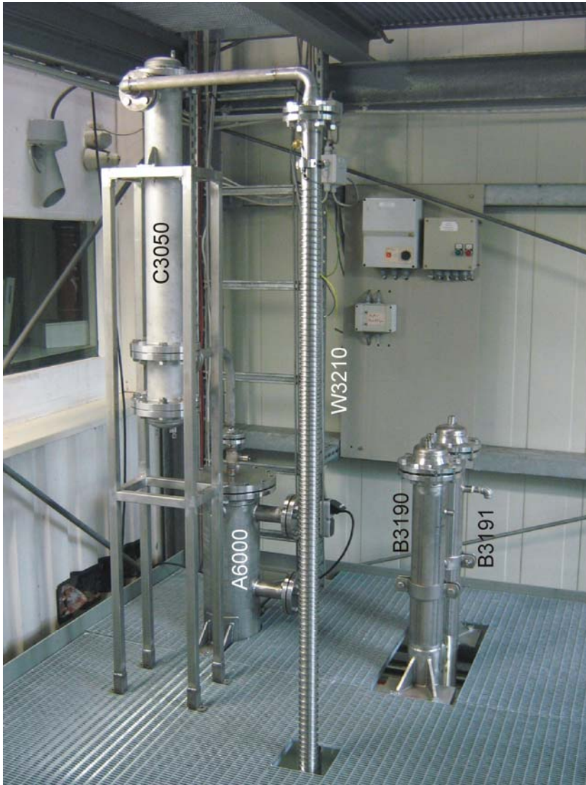
Abbildung 56: Aufbau der Technikumsanlage vor Isolierung, Teil 2
